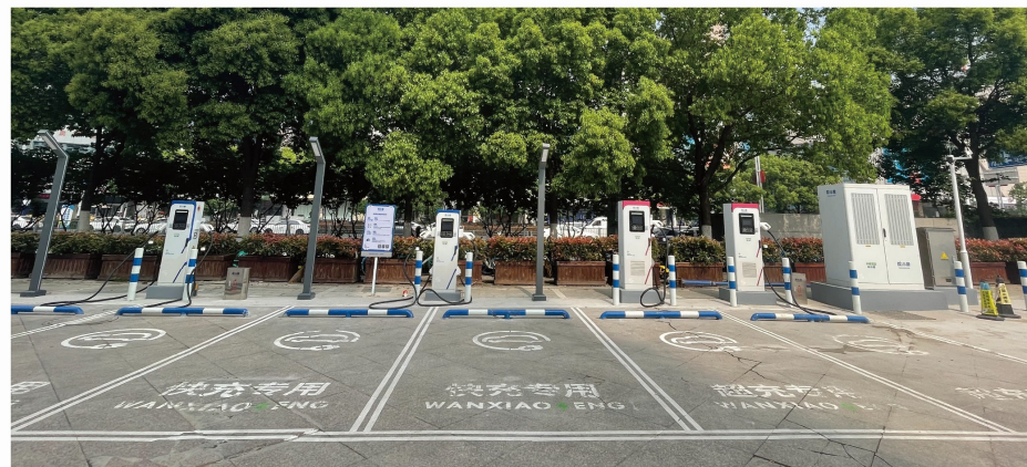
(探索新能源资产运营新模式，与中安能源合作建成盐业大厦生态能源充电站)
